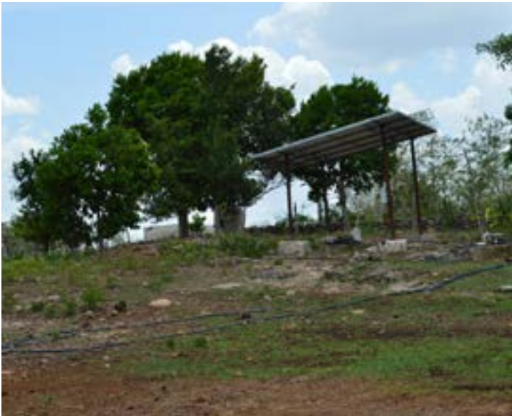
Pozo profundo con ennergía solar en Sotuta de Peón.
