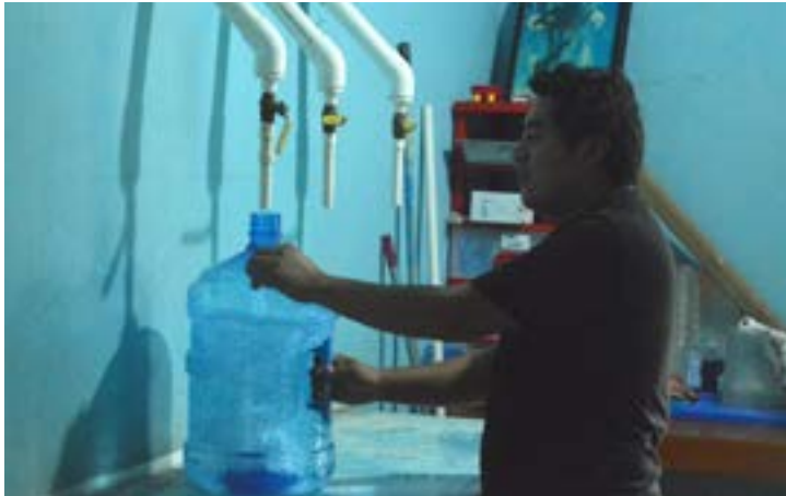
Planta purificadora de agua en Tiholop.
